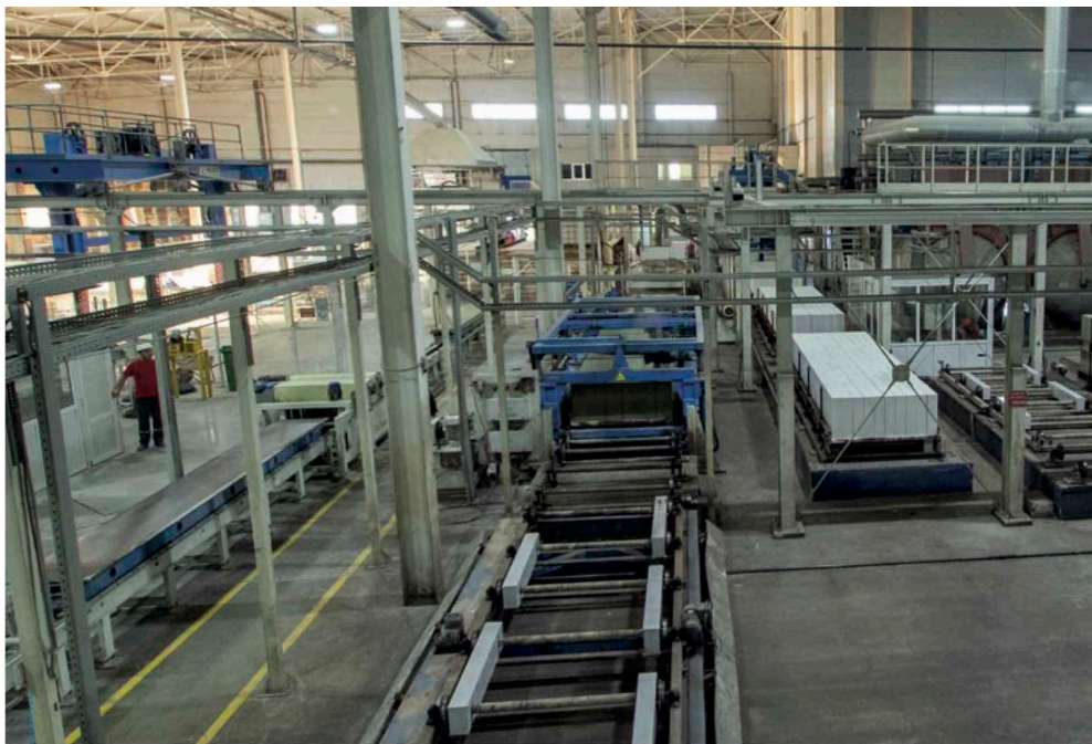
Вид сверху на производственную линию, зона кантования (слева), зона автоклавирования (справа)
